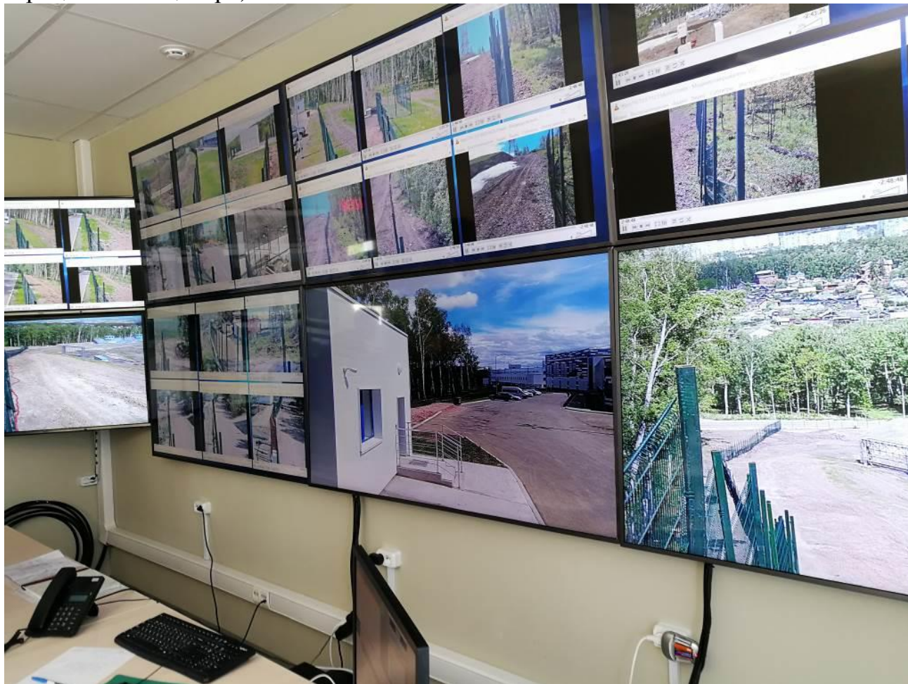
Фотография 4. Система видеонаблюдения на объекте «Сопка» (по состоянию на 1 июня 2019 г.)
