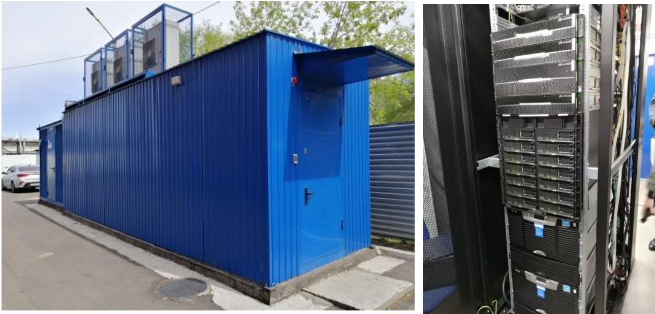
Фотография 3. Резервный ЦОД.
